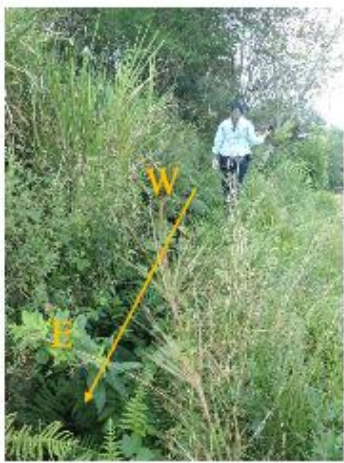
Figura 7. Estado de la zanja de coronación.
